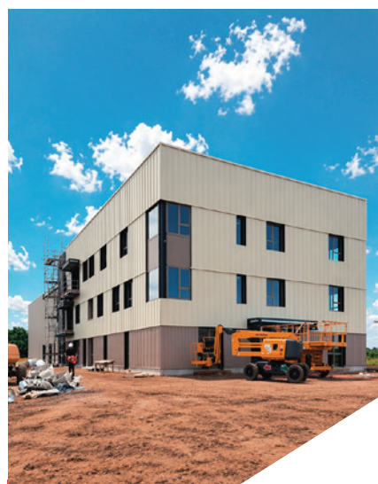
Nouveau siège social de FAAC Entrance solutions France en construction sur le parc d'activités du Levant, Lieusaint (77).
